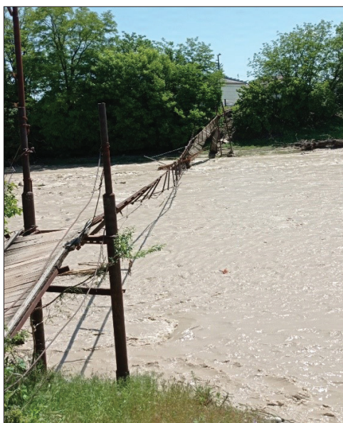
Рис. 2. Разрушенный навесной пешеходный мост через реку Нальчик [Fig. 2. Destroyed hinged pedestrian bridge over the Nalchik River]
