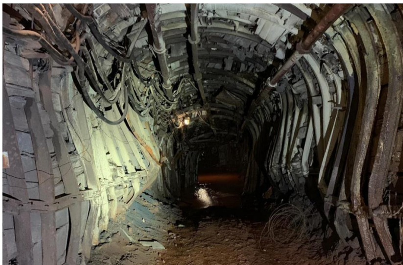
Рис. 3. Деформации металлической арочной крепи в результате действия горного давления в породном массиве. [Fig. 3. Deformations of a metal arch support as a result of rock pressure in a rock mass.]
